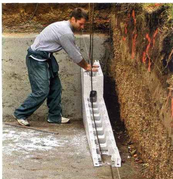
Cet astucieux procédé de construction utilise des agglos à bancher en polystyrène qui sont armés et dans lesquels on coule du béton. Le revêtement est assuré par un liner pour les bassins de forme traditionnelle à skimmers ou en liner armé pour les piscines à débordement et à formes plus compliquées. L'Esprit Piscine.
